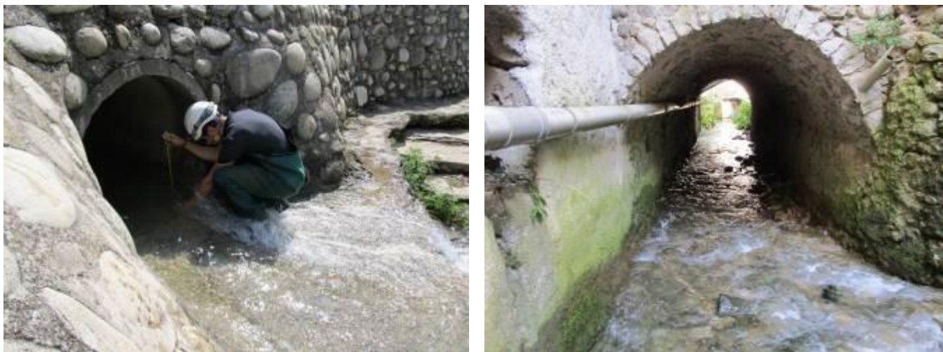
Figure 30 : mesure des hauteurs d'eau au niveau des sources Estugnes Nord et Sud
