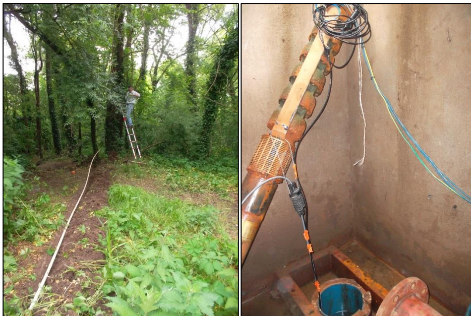
Figure 106 : Installation du boîtier d'acquisition avec antenne GSM à l'extérieur du forage dans un arbre (à droite) et de la sonde du fluorimètre dans le forage F1 de Gerbial (à gauche)
